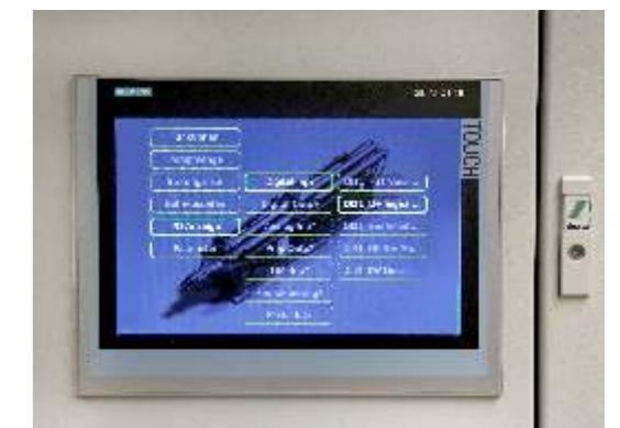
Panel Touch Screen para Operación del Sistema de Bombeo
