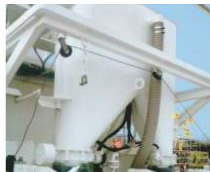
Balança de dosagem de cimento e água
